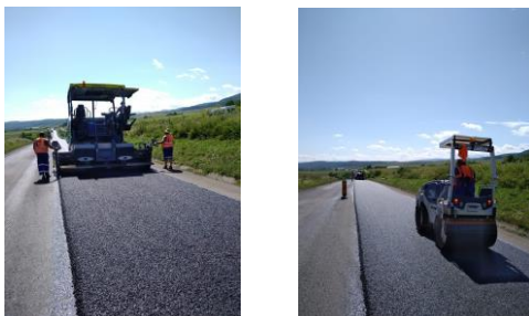
Așternere de covor asfaltic pe drumuri cu un grad de îmbătrânire redus
