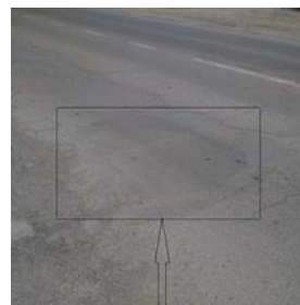
Plomba realizată pe timp friguros în februarie 2011 Poză realizată în aprilie 2017
