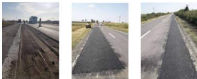
Frezare nejustificată pe suprafețe neafectate de defecte și așternere de covoare asfaltice
