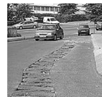
Refacere defectuoasă a infrastructurii rutiere după intervenții la utilități
